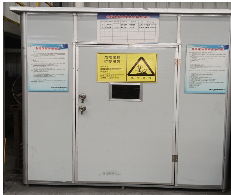
危废暂存间照片
